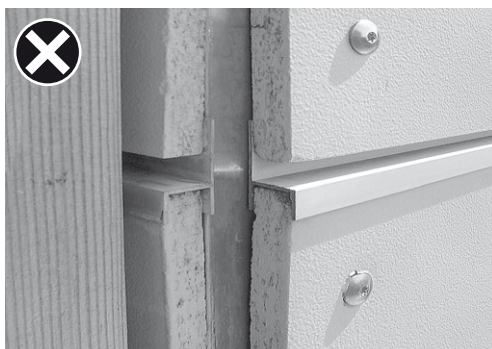
Nevyrovnaný podklad pod deskami
